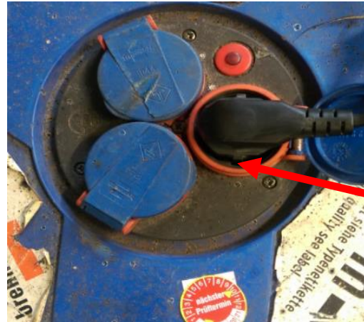
Beispiel eines nicht geeigneten Anschlusssteckers an einer für den Außeneinsatz geeigneten Kabeltrommel. (Anschlussstecker besitzt keinen Wasserabweisenden Schutzkragen).
